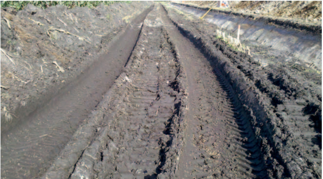
Abbildung 1: Tiefe Fahrspuren entlang eines Leitungsgrabens
