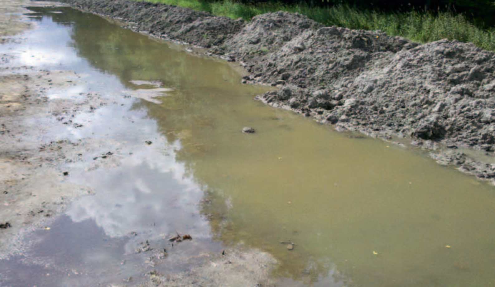
Abbildung 3: Unter solch nassen Bedingungen mit stehendem Wasser auf der Bodenoberfläche dürfen keine Erdarbeiten ausgeführt werden
