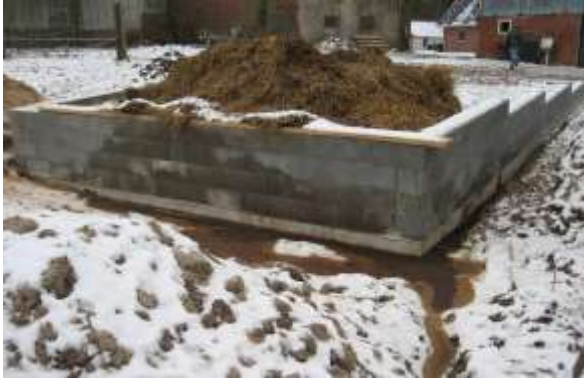
Abbildung 1: Negativbeispiel: Das neu errichtete Festmistlager hat undichte und zu niedrige Seitenwände. Ein Ablauf für die anfallende Jauche ist nicht vorhanden.
