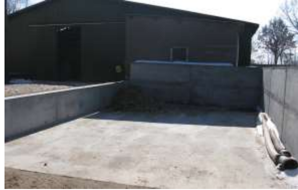
Abbildung 2: Positivbeispiel: Ein ausgedienter Güllebehälter kann als Festmistlager umfunktioniert werden, ein Ablauf für die Jauche zur Vorgrube ist vorhanden.
