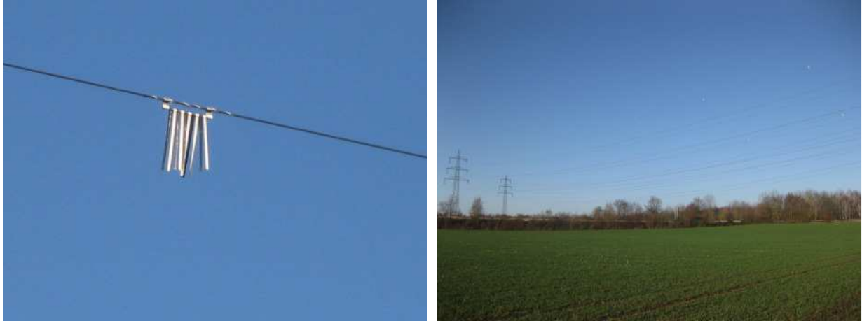
Abbildung 5: Erdseilmarkierung einer Freileitung
