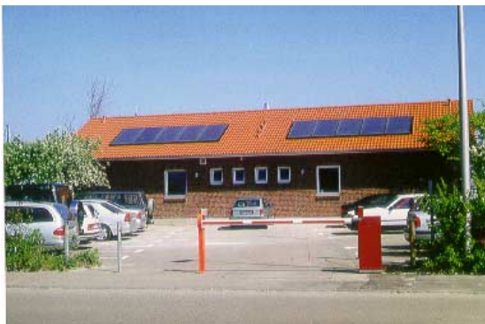
Solarzellen auf dem Dach des Sanitärgebäudes im Jachthafen Heiligenhafen
