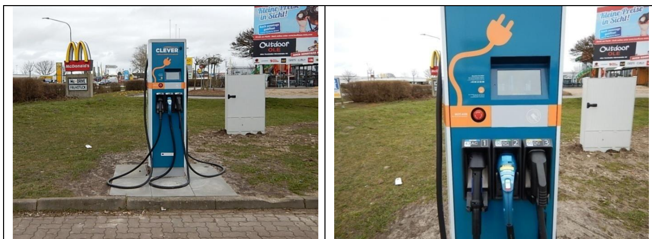
Abbildung 7: Ladestation für Elektromobile am Landkirchener Weg in Burg (eigene Aufnahme, 2016)
